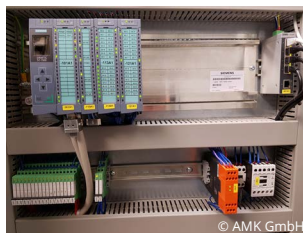
zugangsgeschützter Bereich der Sensorverkabelung
