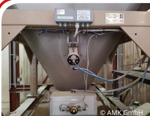
kabelgebundene Sensoren am Premixer
